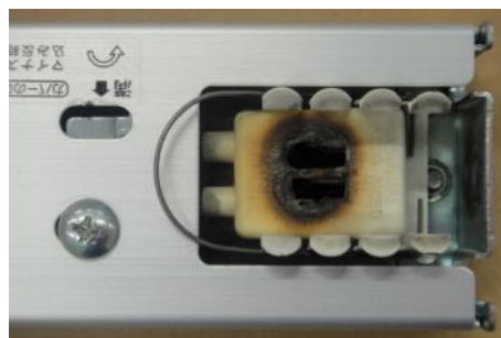
《長期使用により過熱したソケットの例》
